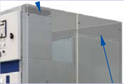
Il condotto sfog gas The gas duct
