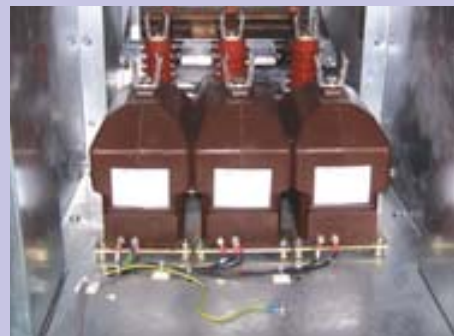
Comparto trasformatori di tensione Measurement compartment
